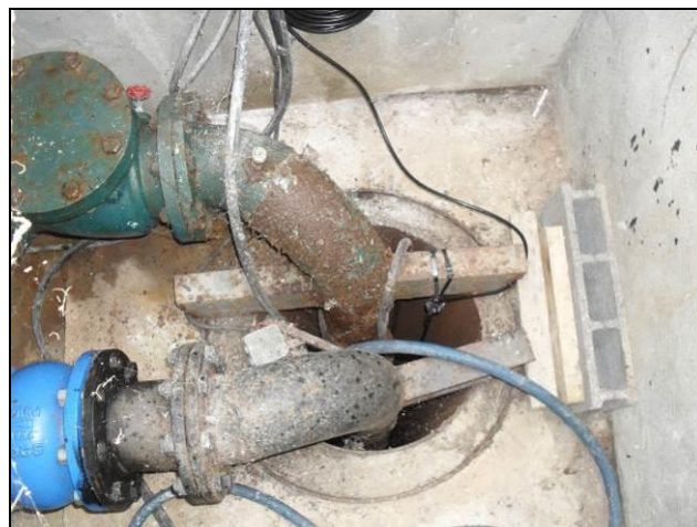
Photographie 2 : Colonne des pompes
