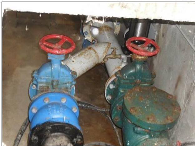
Photographie 3 : Vannes de régulation des débits de pompage et robinet de prélèvement eau brute
