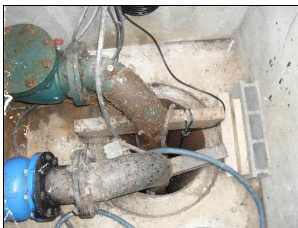
Photographie 10 : Colonne des pompes
