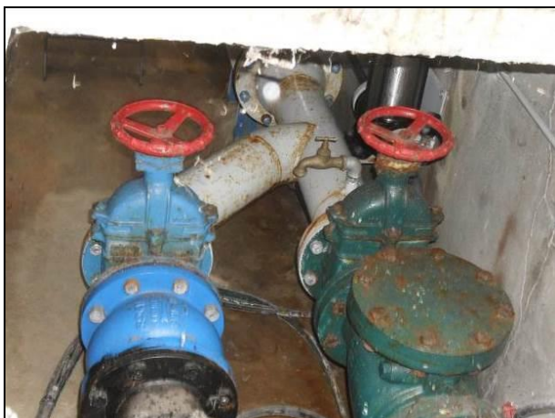
Photographie 11 : Vannes de régulation des débits de pompage et robinet de prélèvement eau brute
