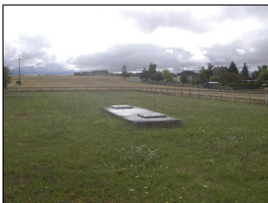
Capot du regard abritant le captage
